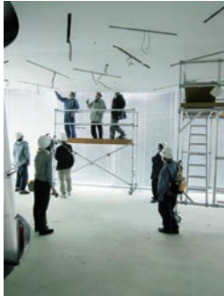
せんだいメディアテーク7階 専門家による被害状況の検証
